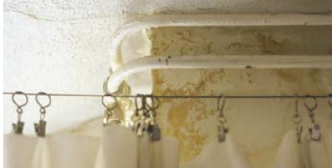
... und zeigen an den Bauteilen solche oder ähnliche Schadensbilder
