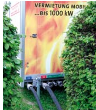
Von der „Outdoor-Heizung“ aus dienen Schlauchverbindungen als Vor- und Rücklauf
