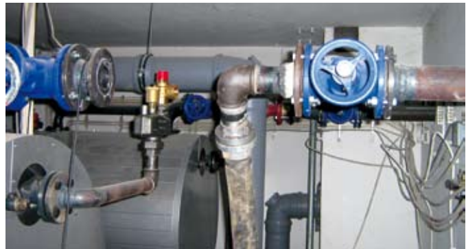
Die Anschlussmöglichkeiten für die Vor- und Rücklaufschläuche wurden vom Heizungsbauer eingerichtet
