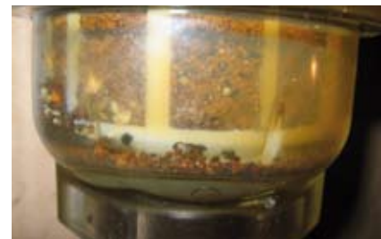
Bei genauem Hinsehen wurde auch bei diesem Exemplar deutlich, dass es wohl schon länger nicht mehr gewartet wurde
