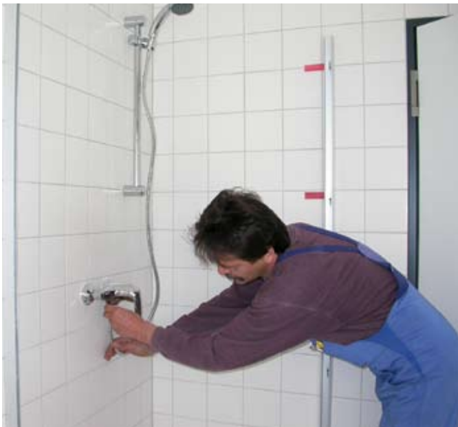
Entnahmearmaturen mit Feinsieben in den Anschlüssen müssen für die Durchführung einer Spülung ausgebaut werden
