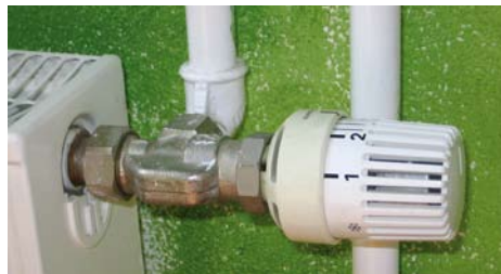
Sinnig: Hier wird der Heizkörperthermostat vom Rücklauf erwärmt
