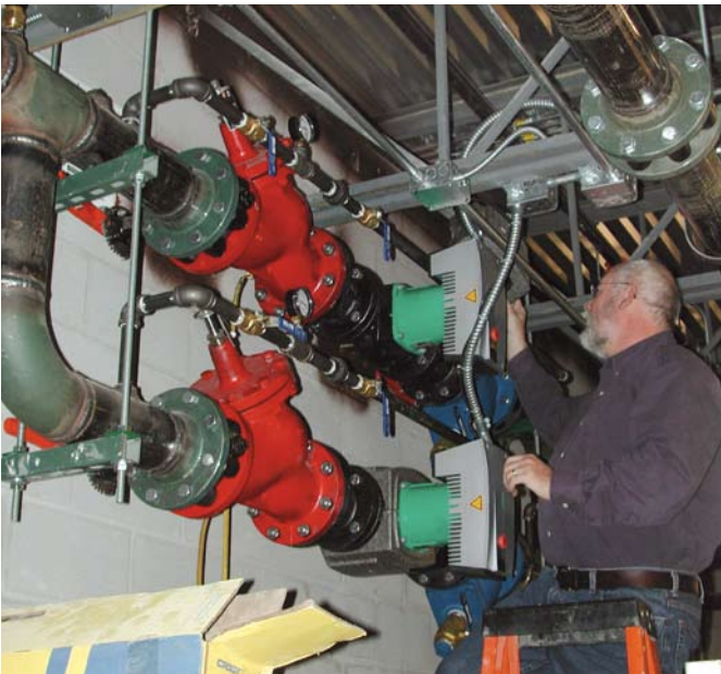
Die Feinabstimmung der Wärmeversorgung in den verschiedenen Heizkreisläufen erfolgt mit zwei geregelten Hocheffizienzpumpen
