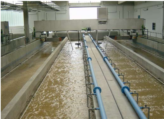
Der Sandfang besteht aus langen, tiefen Rinnen und hat die Aufgabe, mitgeführten Sand aus dem Abwasser zu entfernen
