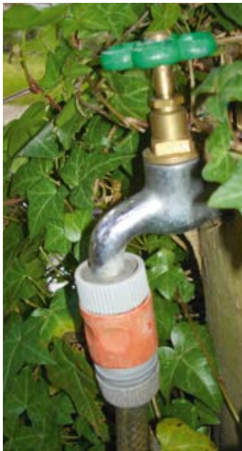
Passt, dicht, funktioniert – und gut. Von Absicherung keine Spur
