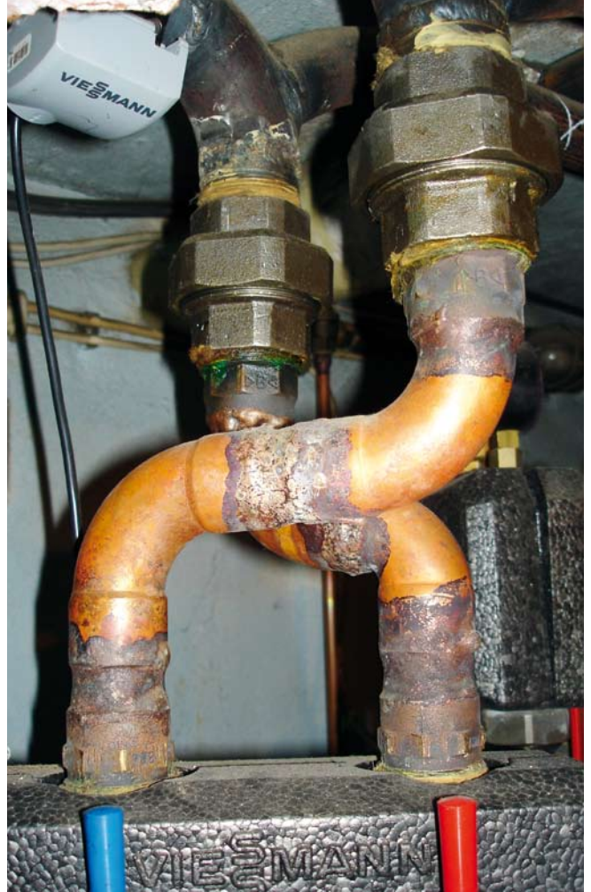
Nackte Heizungsleitungen sind wie Heizkörper ohne Abschaltmöglichkeit
