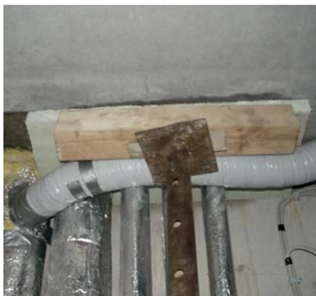
Nie wieder solche Konstruktionen, die nur selten den Anforderungen des Brand- und Schallschutzes entsprechen
