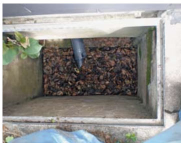
Schon seit 1992 verboten: Abgasabführung über Lichtschacht
