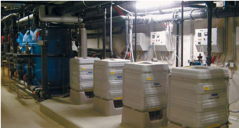
Die Chlor-Ozon-Anlage produziert aus harmlosem Kochsalz das nötige Desinfektionsmittel
