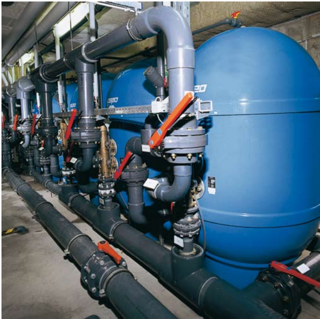
Die Filteranlage ist das Herzstück der Schwimmbad-Wasseraufbereitung
