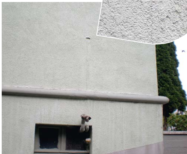
Eine Unterputz-Öltankentlüftung – da hätte der Tank schnell dicke Backen gemacht
