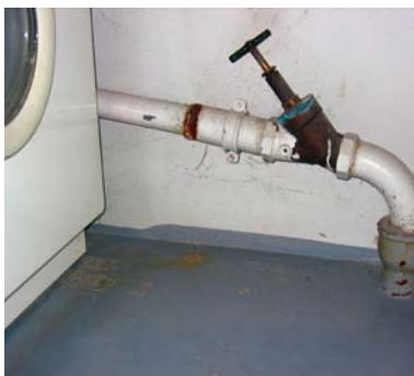
Geht nicht gibt's nicht: Ein Schrägsitzventil im Abfluss als Rückstauschutz
