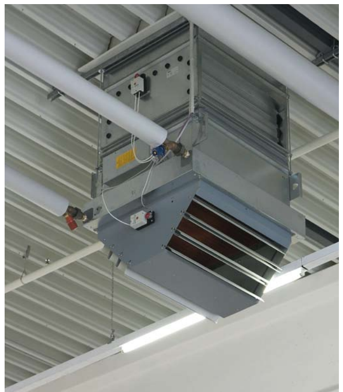
Mischluftgerät von der Halle aus gesehen: Durch den senkrechten Kanal wird frische Luft angesaugt und im Gerät mit Umluft vermischt
