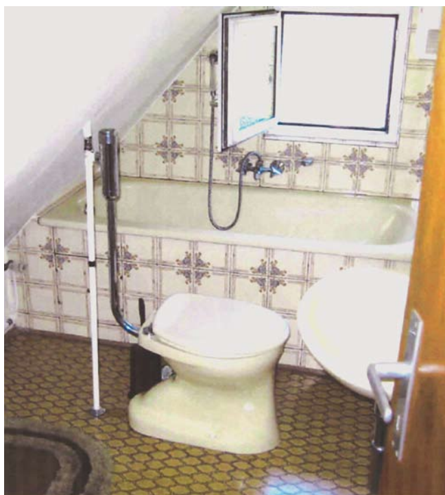
Freiluft-Wasserleitung für eine sehr zentrale WC-Installation – toll!
