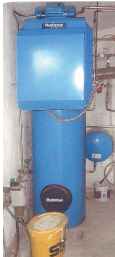
Der Kessel auf einem stehenden Trinkwassererwärmer... krass!
