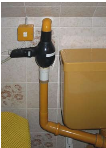
Der Prototyp der WC-Geruchabsaugung mit Rohr und Fön
