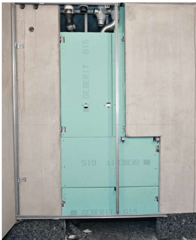
Zwischen den Bädern liegt ein mit Quattro Trennwand F90 beplankter Versorgungsschacht
