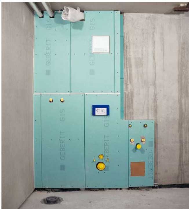
Die fertig beplankte Vorwand erfüllt alle baurelevanten Anforderungen des Brand- und Schallschutzes
