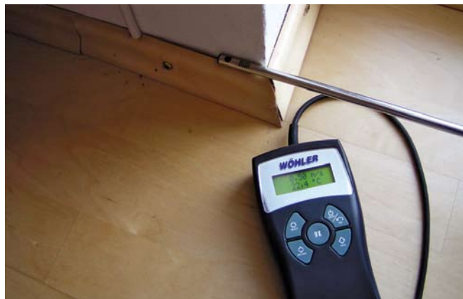
Ein Thermoanemometer kann zweifelsfrei Leckagen erkennbar machen
