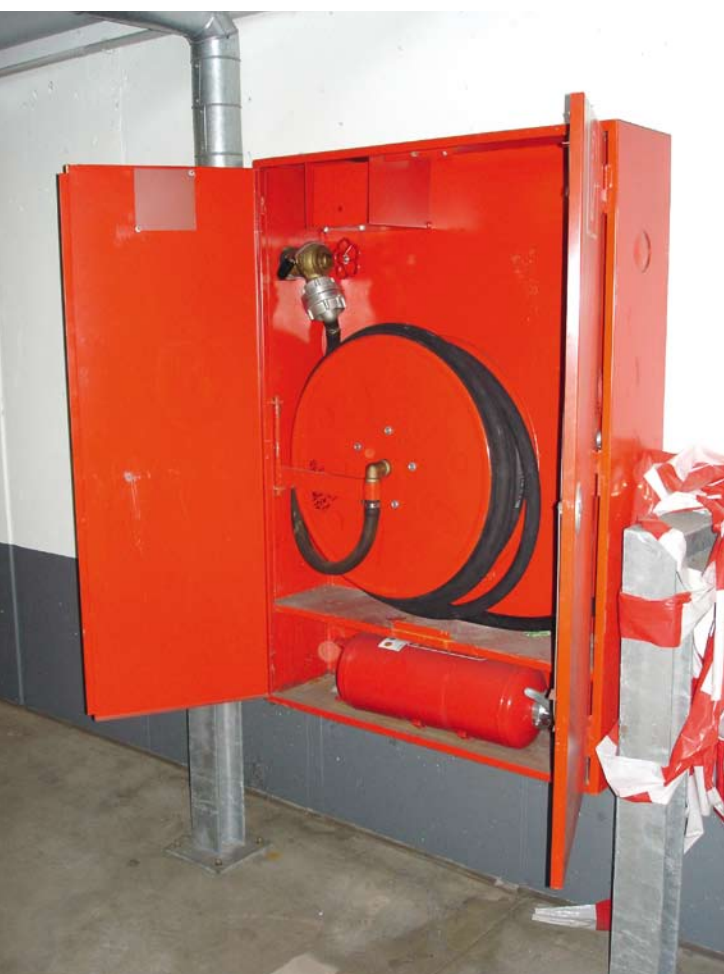
Wandhydranten des Typs F dürfen nur noch mittelbar mit Trinkwasser als Löschmittel versorgt werden
