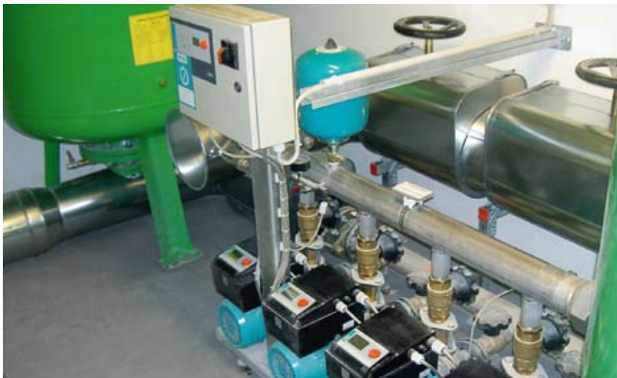
Für den Druck sorgen dann modulierend betriebene Pumpen, die als Grundlast-, Reserve- und Spitzenlastpumpe arbeiten
