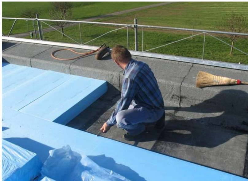
Hier entsteht ein Umkehrdach, die wasserdichte Bahn ist geschützt unter der Dämmung
