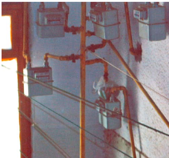
Freistil-Gasinstallation im Treppenhaus. Hier: die Schwebezähler
