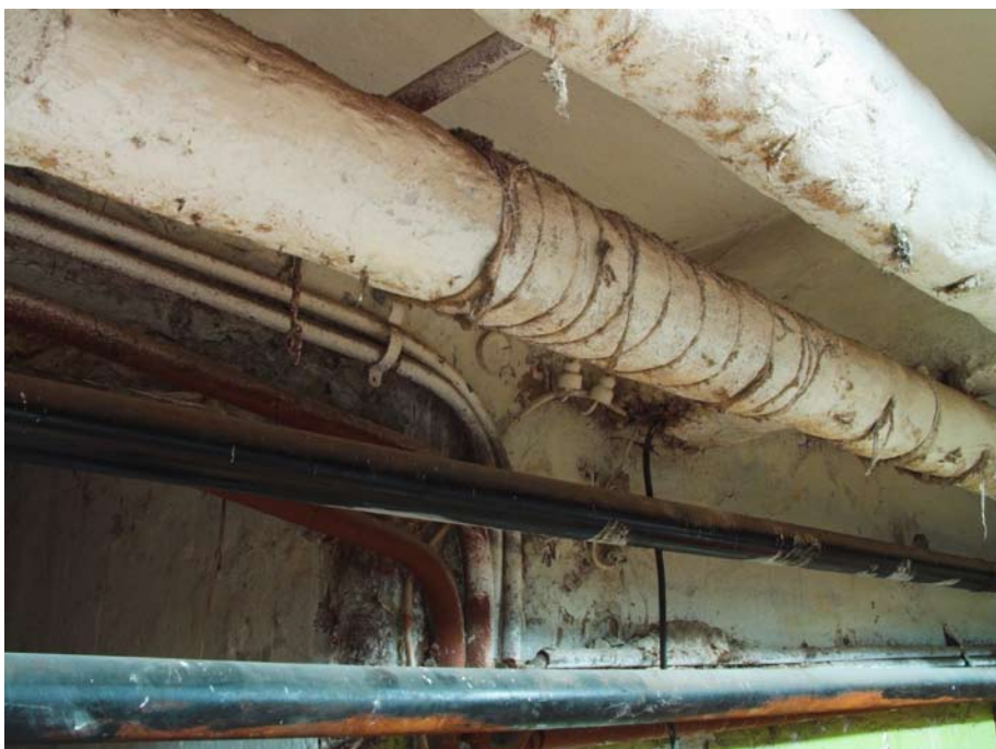
Gammelige Installationen sind ein Problem des Hausbesitzers – nicht das seiner Versicherung
