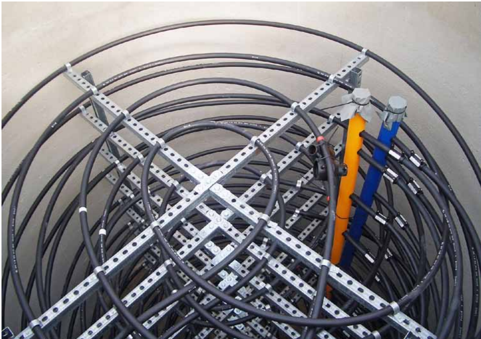
Die äußere und innere Rohrspirale zur Regeneration und Energieentnahme
