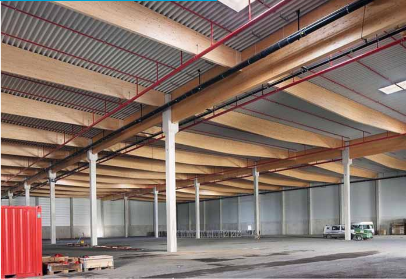
Die schwarzen Leitungen unter der Decke gehören zur Druckströmungsentwässerung, rote Leitungen zur Sprinkleranlage
