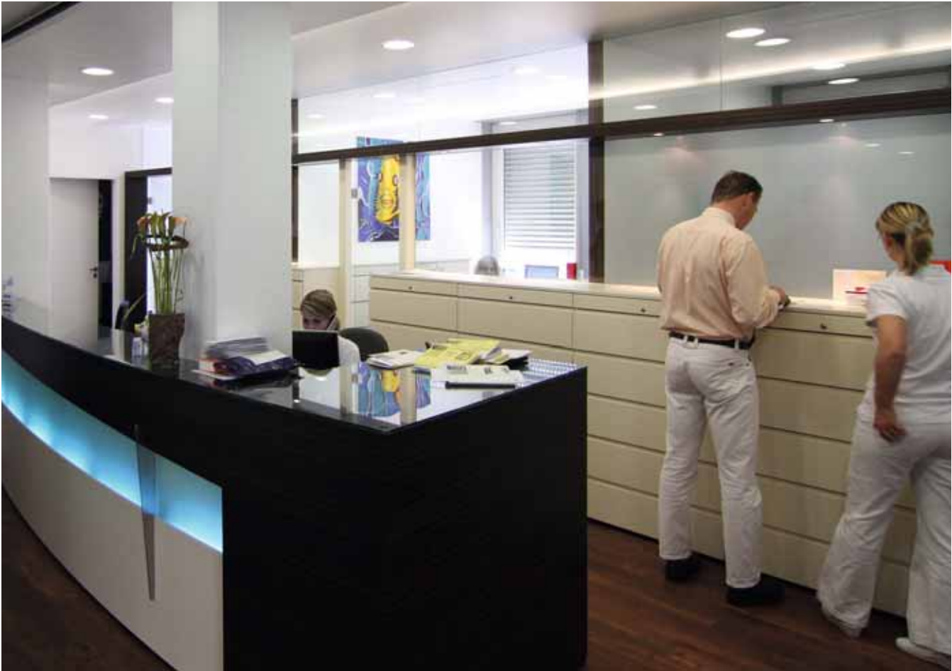
In dieser Arztpraxis wurden die flachen Gea-Gebläsekonvektoren so in die Decke integriert, dass die Raumhöhe beinahe unverändert bleibt
