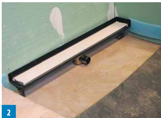
2 Nachdem die Aussparungsschalung entfernt ist, kann mit dem Einbau begonnen werden. Dazu wird die Duschrinne sorgfältig ausgerichtet
