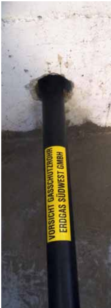
So kommt der Anschluss ins Haus
