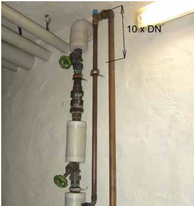
Ein Sicherheitsventil mit Anschluss über der Oberkante des Trinkwassererwärmers. Gut gemeint, aber mit zu langer Stagnationsstrecke
