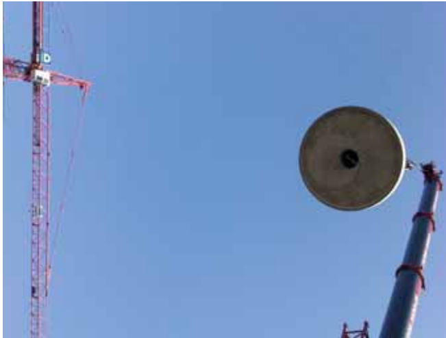
Von unten sichtbar der Beton-Konus als Abdeckung mit zwei Verschlüssen und Entwässerung des Zwischenraums der beiden Dichtungsebenen bei eventuell entstehendem Kondenswasser
