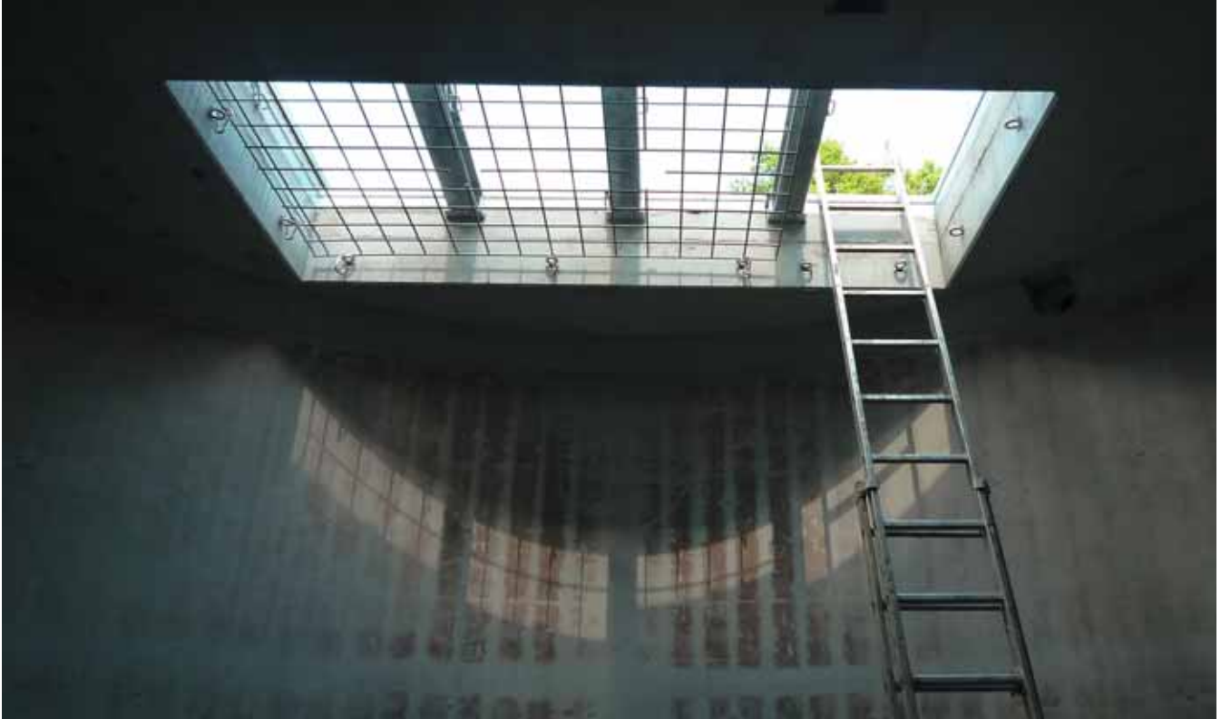
Innenansicht eines Hackschnitzelbehälters mit Blick auf die Befüllöffnung
