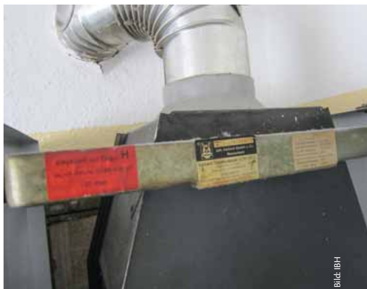
Kennzeichnend für den Typ B1 ist die Strömungssicherung
