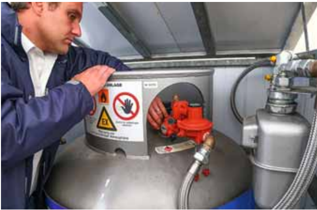
Mit wenigen Handgriffen ist der mobile Behälter sicher angeschlossen und sorgt für ausreichend Energie
