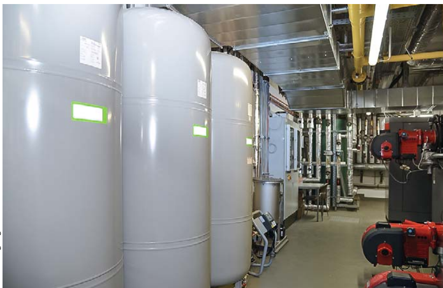
Heizzentrale im Krankenhaus Mara mit Pufferspeichern
