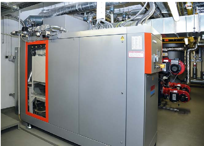
BHKW im Krankenhaus Mara in Bielefeld
