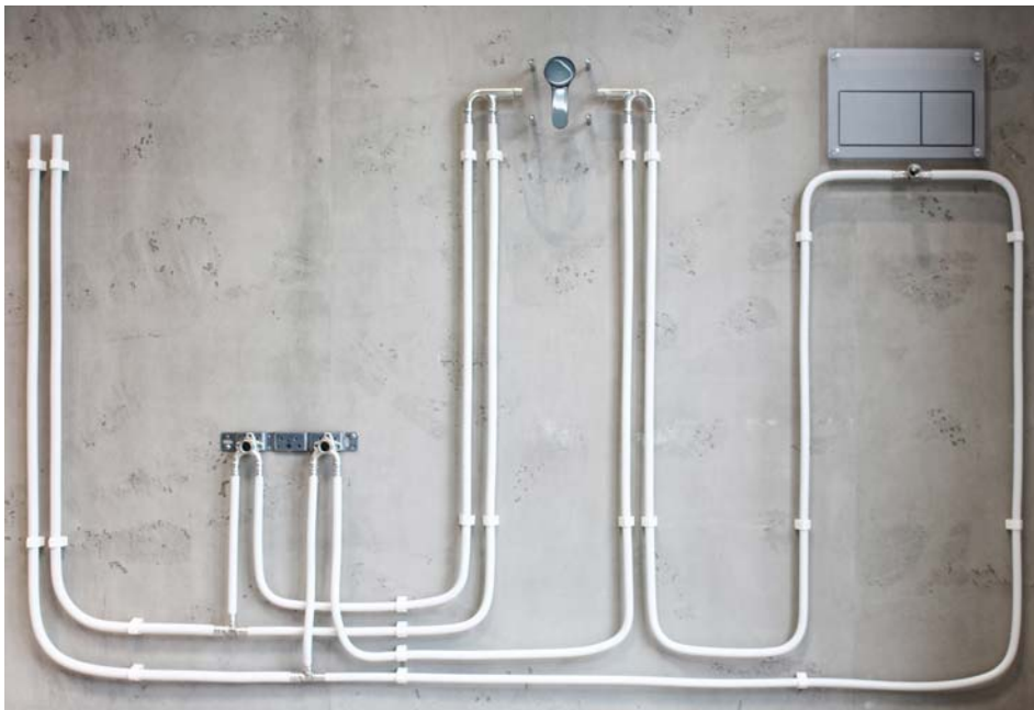
Wirkungsvolle Kombination: Mit Durchschleif- und Biegetechnik entsteht eine hygienisch optimale Stockwerksinstallation mit geringem Wasserinhalt und bestmöglichen Voraussetzungen für den Wasseraustausch
