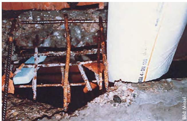
Vor Beschädigungen durch einen herumliegenden Nagel oder scharfe Kanten, z. B. bei Durchbrüchen oder vorstehenden Armierungen, schützen nur hochwertige Dämmungen
