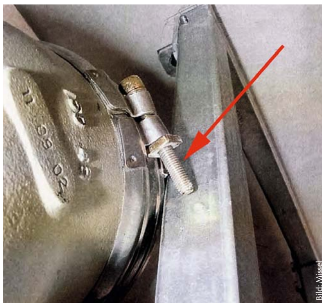
Sind Rohrleitungen nicht gedämmt, können Körperschallbrücken z. B. durch einen Kontakt mit dem Vorwandprofil entstehen
