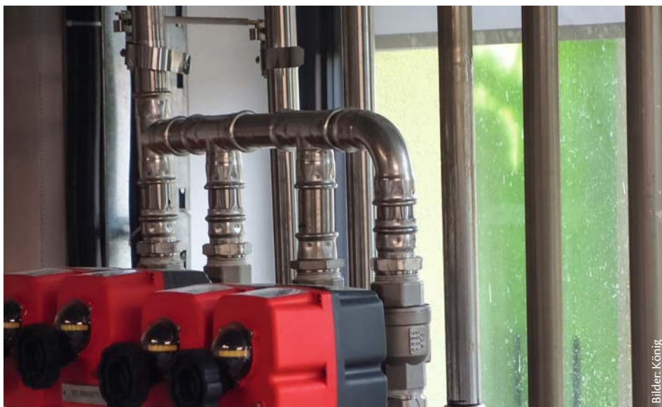
Blick aus dem Technikraum im Erdgeschoss durch die Fassade mit Bioreaktoren nach außen. Links im Bild Ventile (rot) zur Steuerung der Versorgung der Mineralstoffzufuhr für die Algen
