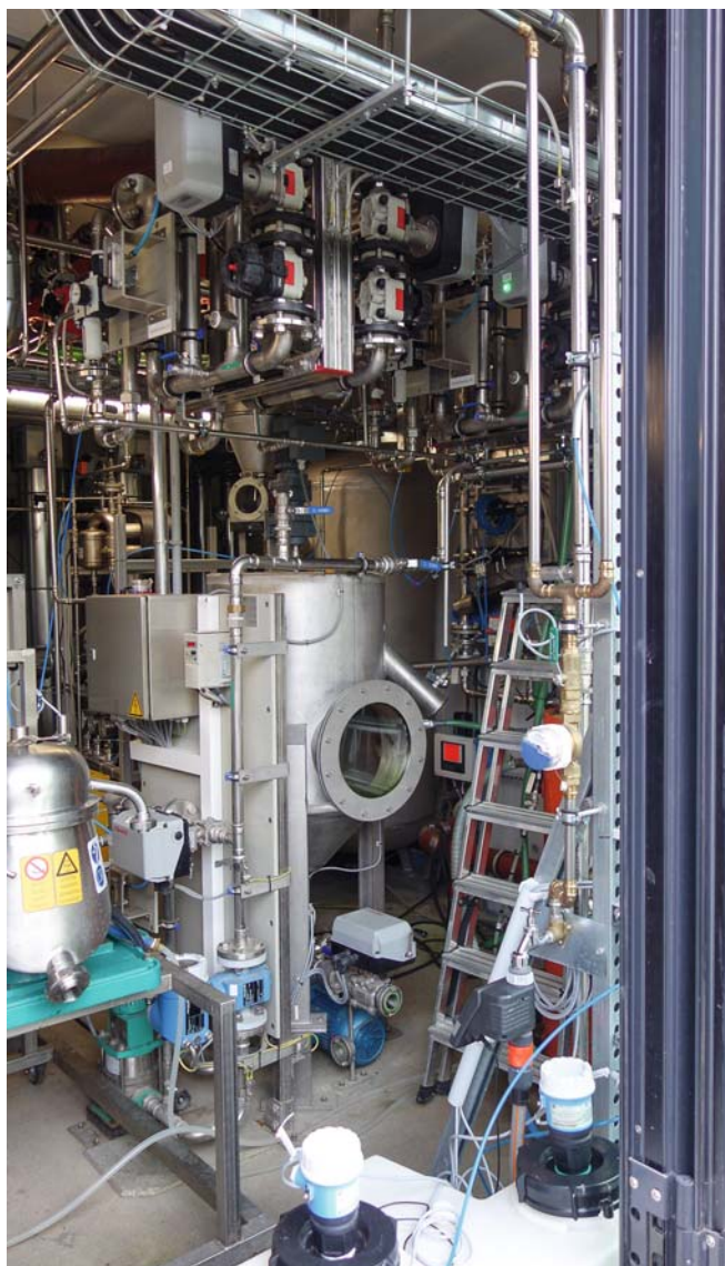
Heizzentrale im Erdgeschoss. In der Mitte das Entnahmegefäß für die aus den Bioreaktoren ausgefilterte Biomasse an Algen. Diese wird weiterverwertet in einer Biogasanlage außerhalb von Wilhelmsburg
