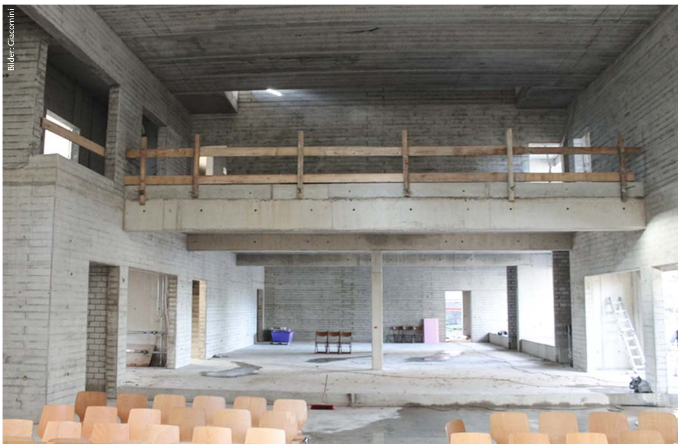
Das Sakralgebäude wurde mit einer Fußbodentemperierung ausgestattet, die unter anderem optimale klimatische Bedingungen für die neue Pfeifenorgel bieten wird
