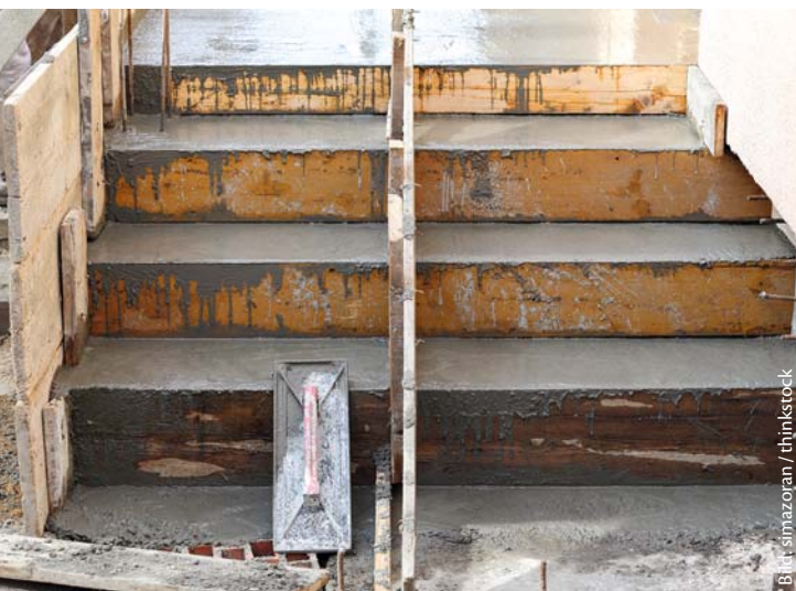
Kubikmeterweise wird Baufeuchte in konventionell gebaute Häuser eingebracht. Das muss nicht sein
