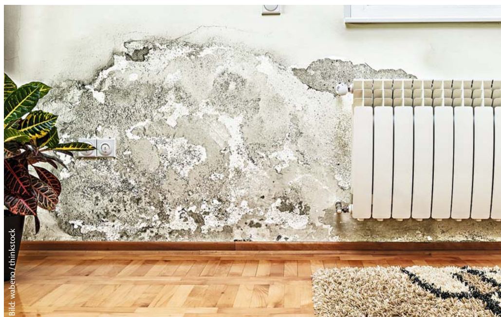
Das Schreckgespenst Schimmel kann durch entsprechend gesunde Bauweise verjagt werden
