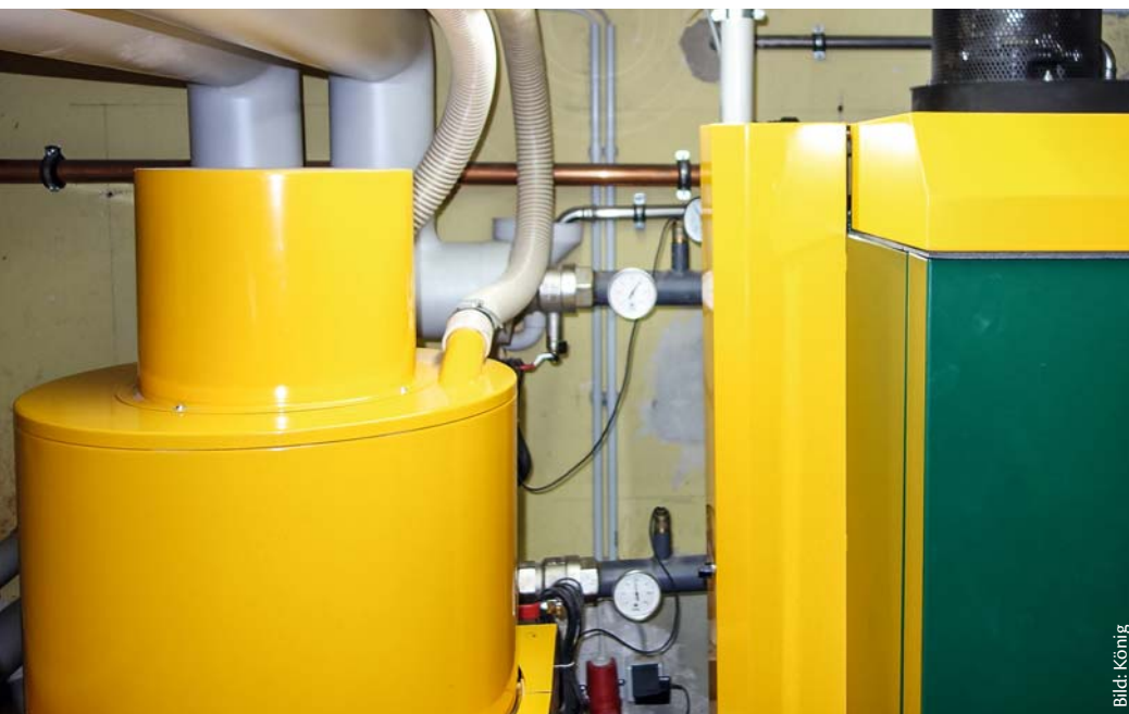
Grundlast-Pelletkessel 80 kW (rechts) und Saugturbine (links) mit flexiblen Leitungen nach oben zur Außenwanddurchführung zum Pelletspeicher
