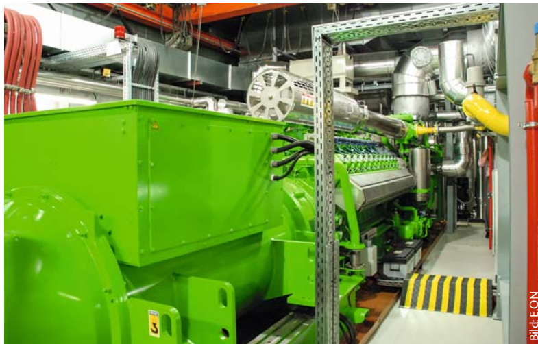
Voraussetzung, um ein Wärmenetz überhaupt wirtschaftlich zu betreiben, ist die Kraft-Wärme-Kopplung, wie hier mittels eines Blockheizkraftwerkes
