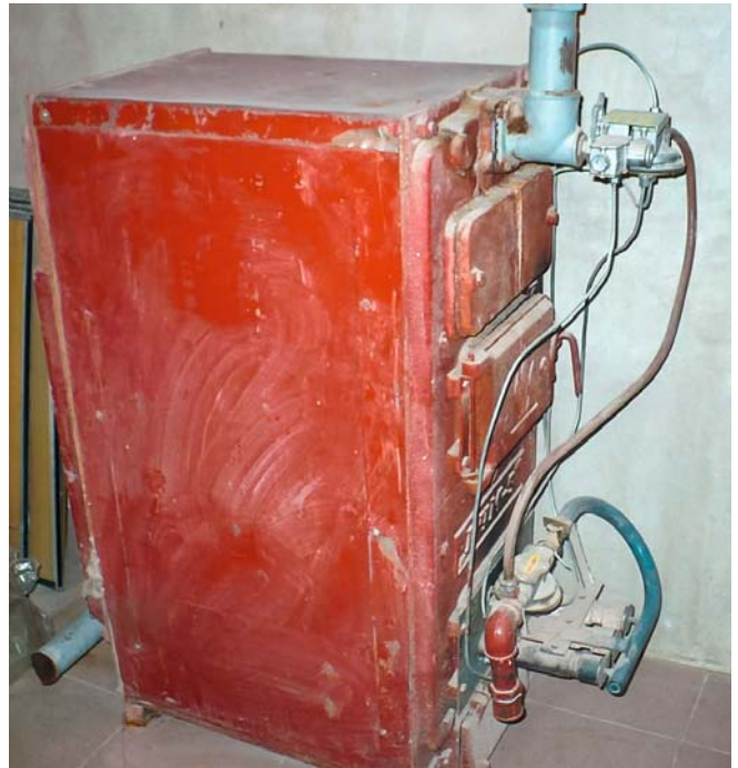
Diesem Kessel ist wohl nicht mehr zu helfen, auch nicht mit Tipps und Tricks aus alten Zeiten
