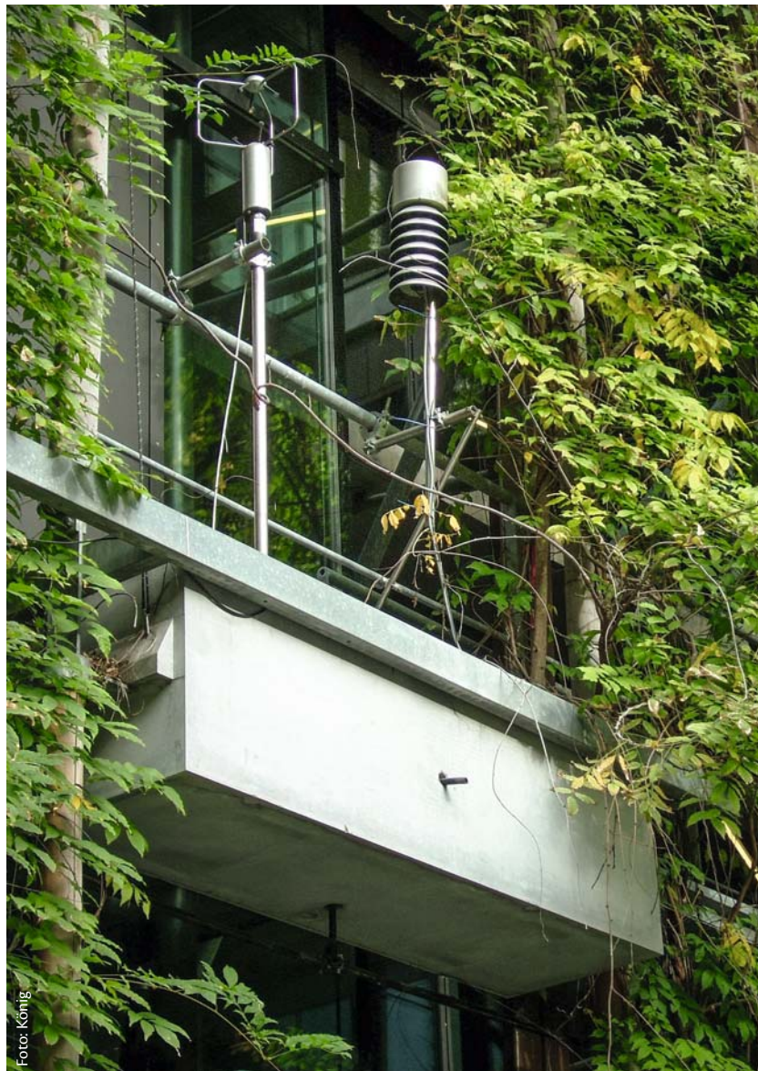
Messtation zur wissenschaftlichen Begleitforschung der passiven Gebäudekühlung durch Begrünung
