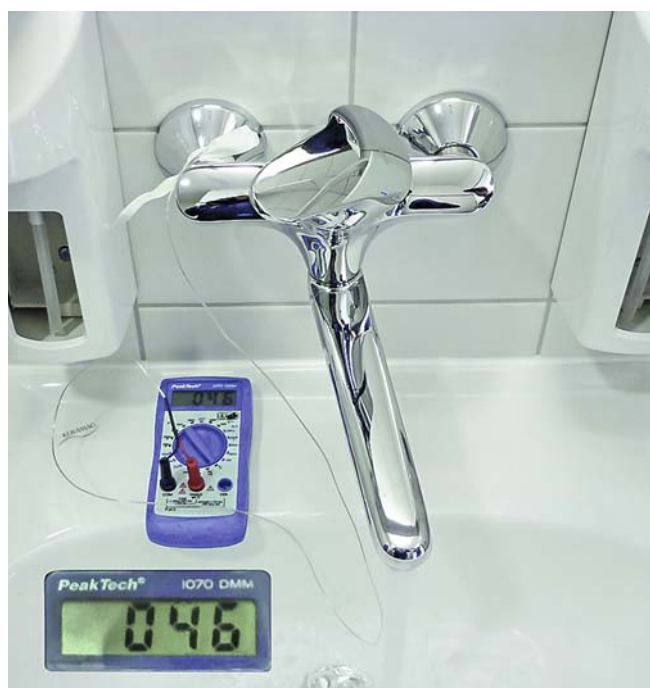
Geschlossene Aufputzarmatur, deren Warmwasserzulauf, wie in Bild 1 dargestellt, in den Kreislauf von PWH und PWH-C integriert wurde
