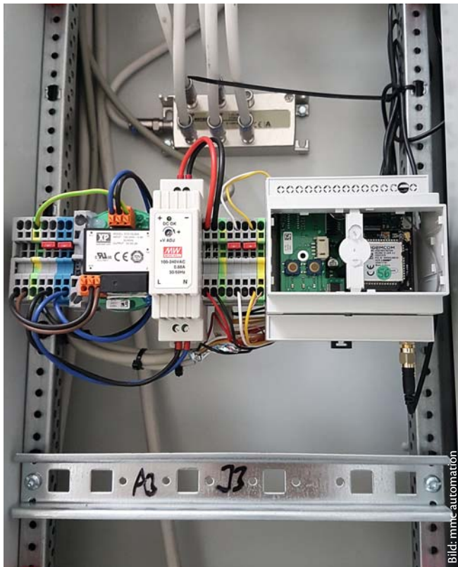
Der Controller inklusive M2M-SIM-Karte der Telekom sitzt im Sicherungskasten
