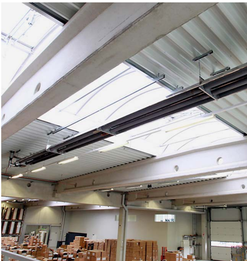
Linearer Zweirohrstrahler in einer Pakethalle von DHL
