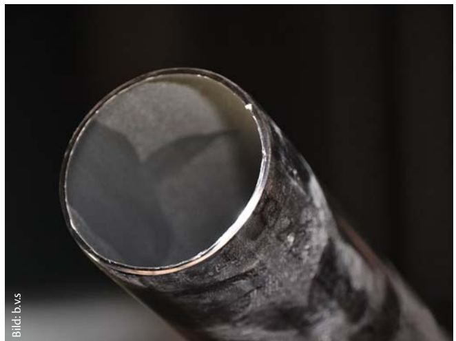
Auch an diesem Rohrende ist die Einschnürung durch den Rohrabschneider sichtbar. Eine fachgerechte Entgratung ist augenscheinlich nicht erfolgt und kann zu Problemen führen
