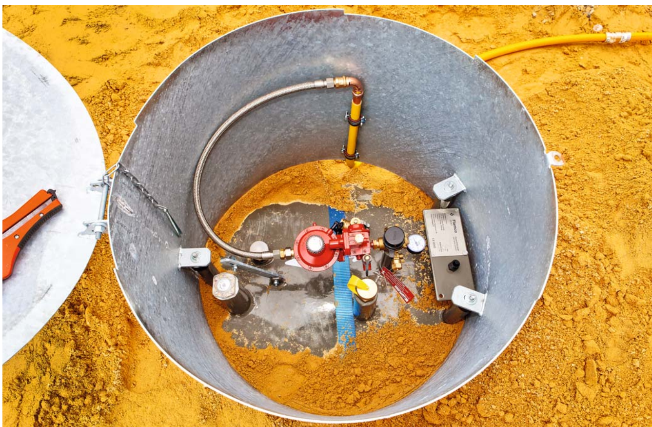
Der Domschacht über dem Flüssiggasbehälter hat Platz für die notwendigen Armaturen einer Flüssiggasanlage. Hier befindet sich bei Anlagen mit kleiner Leistung die Druckregelung zur Expansion des zuvor flüssigen Gases auf dann gasförmige 50 Millibar
