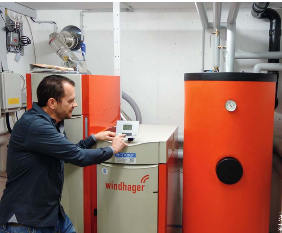
Heiztechnik mit Pelletkessel 30 kW und Pufferspeicher im Technikraum eines Mehrfamilienhauses. Im Hintergrund die Schläuche eines pneumatischen Entnahmesystems
