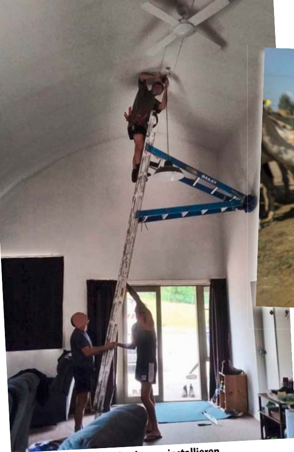
Wenn Gefahrsucher eine Lampe installieren
